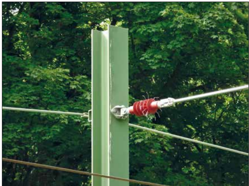
Abbildung 6: Kotschoten an einem Oberleitungsmast der Kaiserstuhlbahn unweit des Uhubrutplatzes zeigen, dass der Mastkopf als Ansitzpunkt genutzt wird (Foto: CHRISTIAN HARMS)
