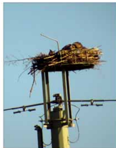
Abbildung 2: Uhu-Brut auf Hochspannungsmast 2015 (Foto: F. BECHINGER)
