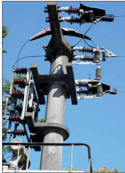
Abbildung 1: Unter diesem Trafomast wurde ein Junguhu tot aufgefunden, Juli 2015. Foto: CHRISTIAN HARMS
